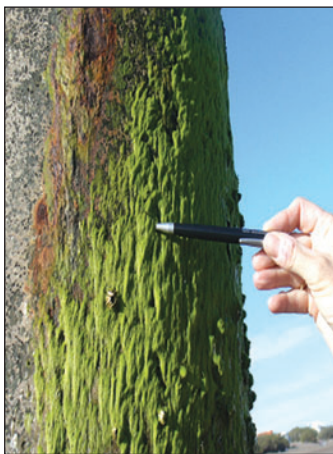
Figura 1.8. Biodeterioro de una estructura de hormigón.
