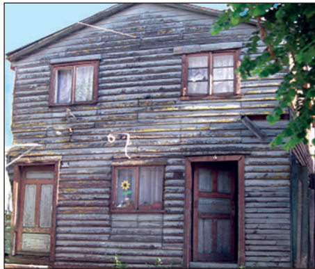
Figura 1.4. Degradación de una vivienda de madera por efecto de la exposición a la intemperie sin una adecuada protección. Osorno, Chile.
