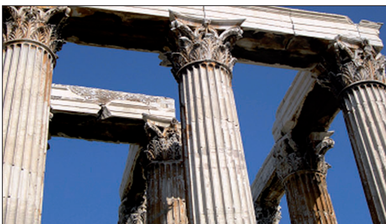
Figura 1.3. Degradación de una construcción de mármol. Templo de Zeus construido entre el siglo VI a.C. y el II d.C. Atenas, Grecia.
