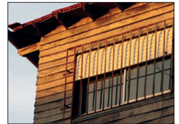
Figura 6.4. Madera dañada por la exposición, sin protección, a los agentes de degradación abióticos.
